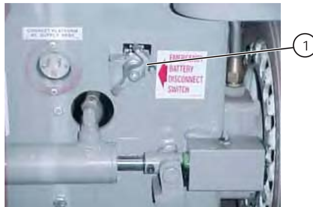
Figura 2-2 Interruptor de emergencia de desconexión de las baterías
